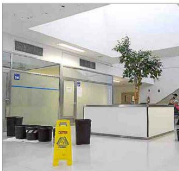
Las goteras, un hecho que desvela el estado del centro.
