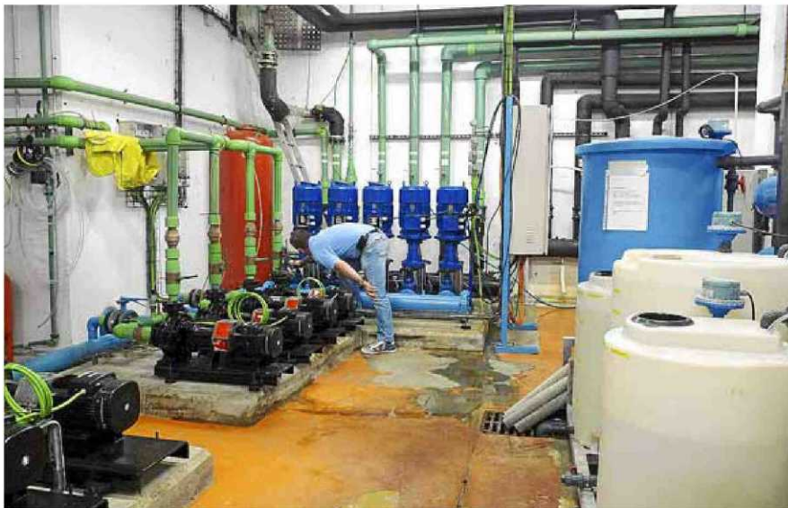
Un operari posa a punt la maquinària que filtra i tracta l'aigua que es consumeix a l'hospital.
